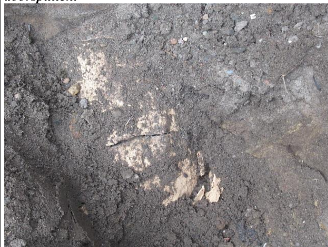
breuk gresbuis bij bezinkput onder dak no. 36 (foto 2022)
